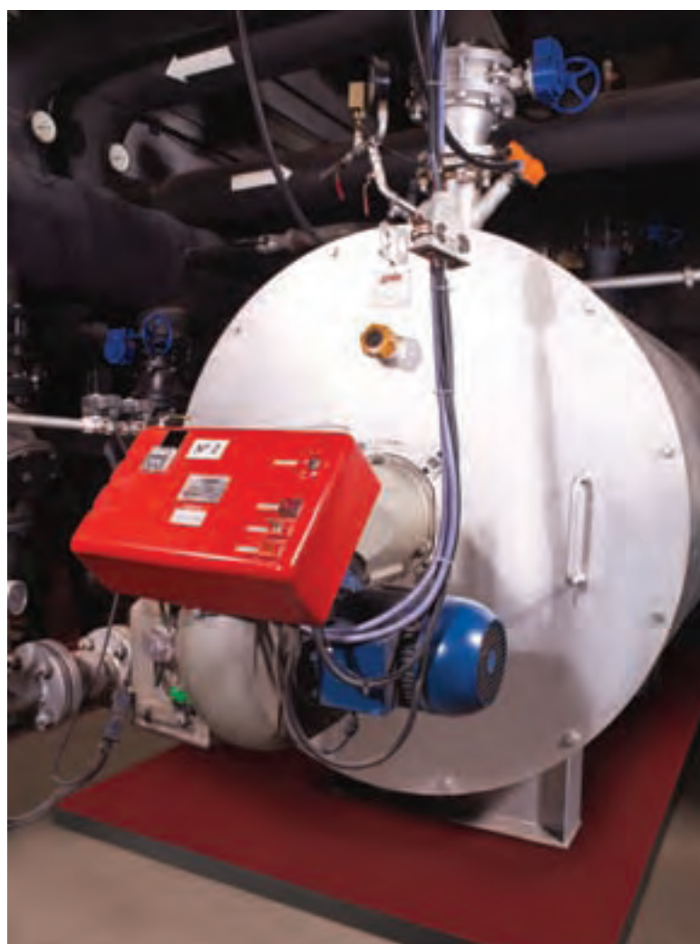
Caldera de agua caliente.
