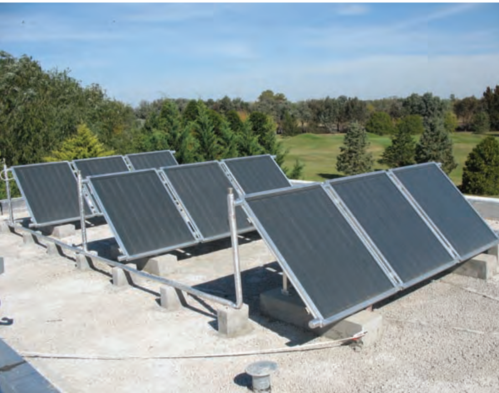
Colectores solares planos para calentamiento de agua.
