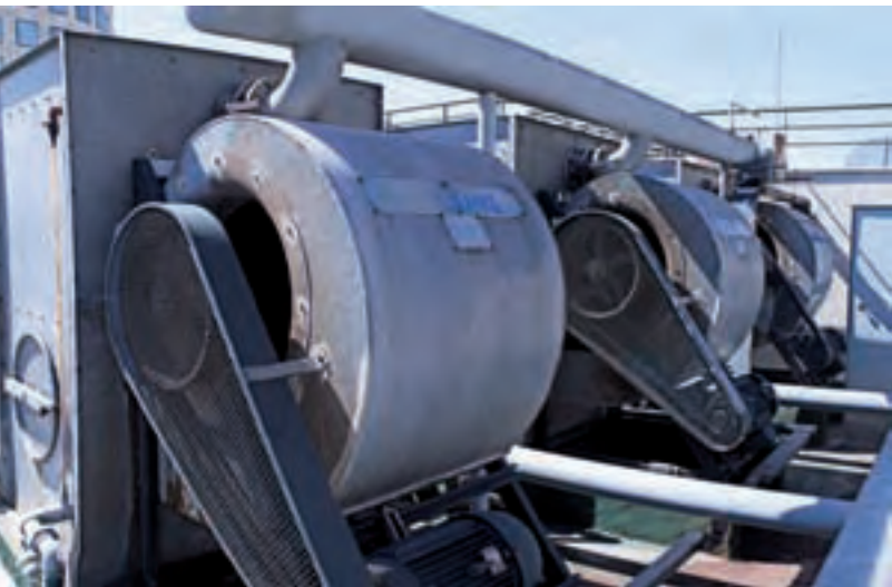
Equipo de enfriamiento.
