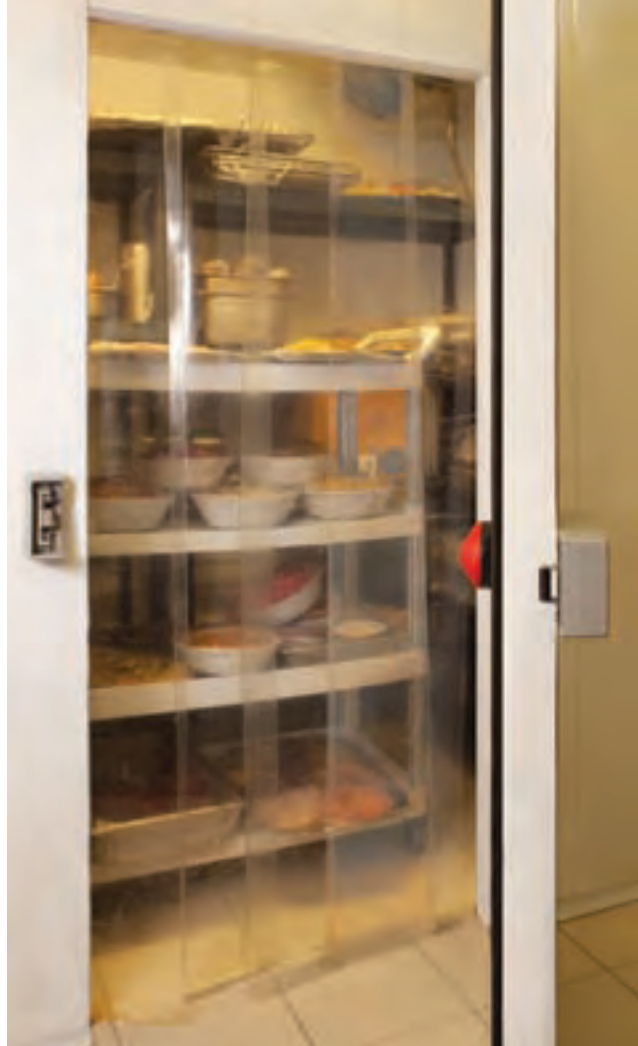
Cámara de frío.
