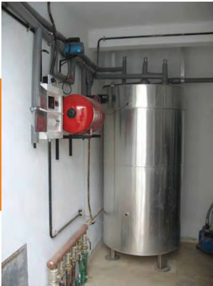
Tanque de acumulación de sistema solar.
